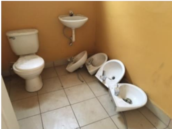
Lavamanos pendientes de instalación
