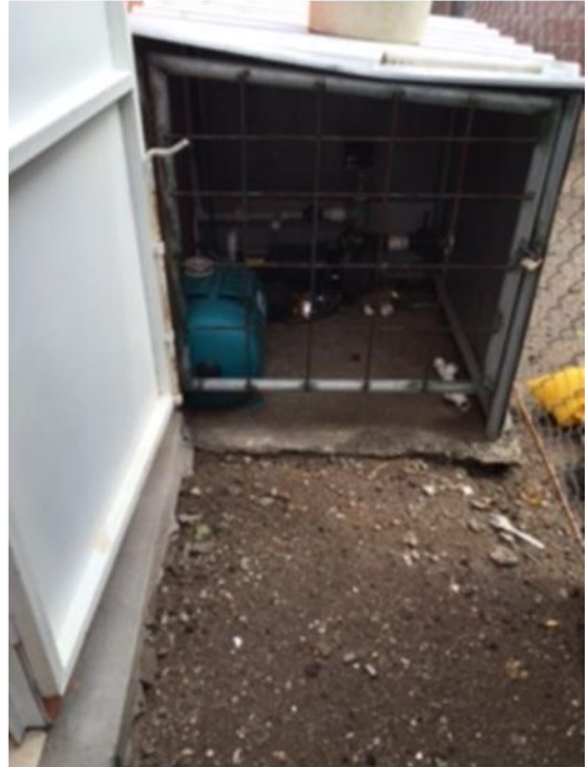
Bomba de agua
